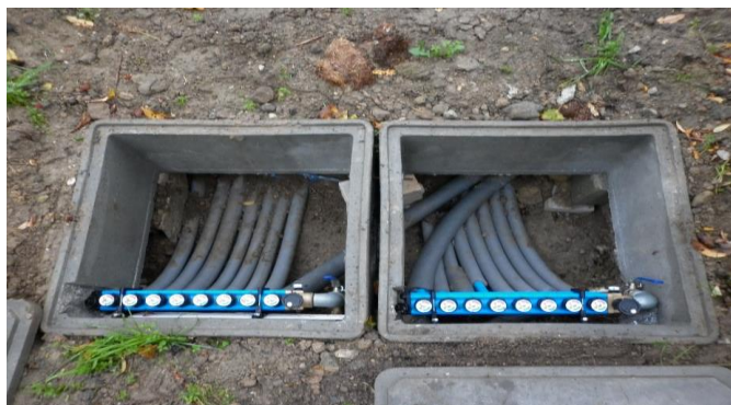
Exemple de réalisation d'un distributeur / collecteur avec ses départs isolés
