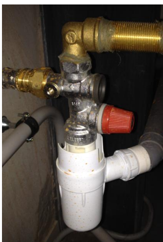
Groupe et son tuyau d'évacuation
